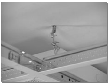
La suspensión puede requerir colgantes adicionales para sujetar el peso de los artefactos de iluminación
